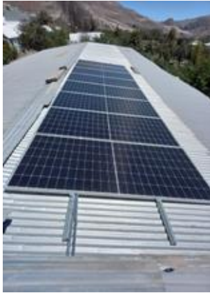
Paneles solares sede Canal La Banda
