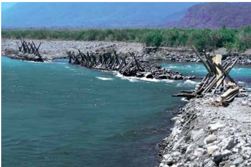
FIGURA 6. Bocatoma rústica colapsada sobre el río.
