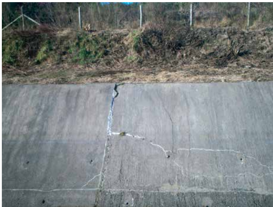
FIGURA 8. Fisuras en revestimientos de hormigón.
