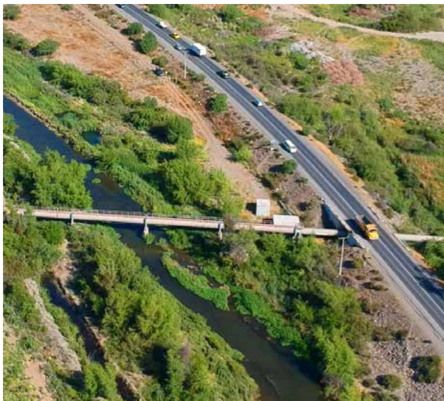
FIGURA 11. Sifón que atraviesa río y carretera.
