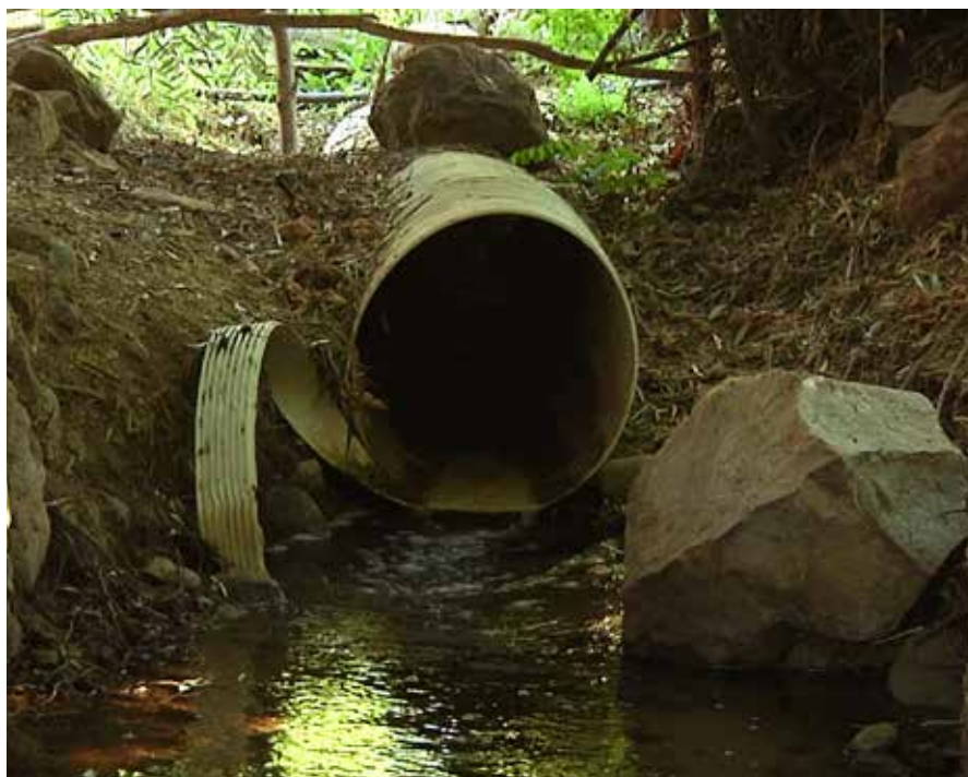
FIGURA 9. Colapso de tubería.
